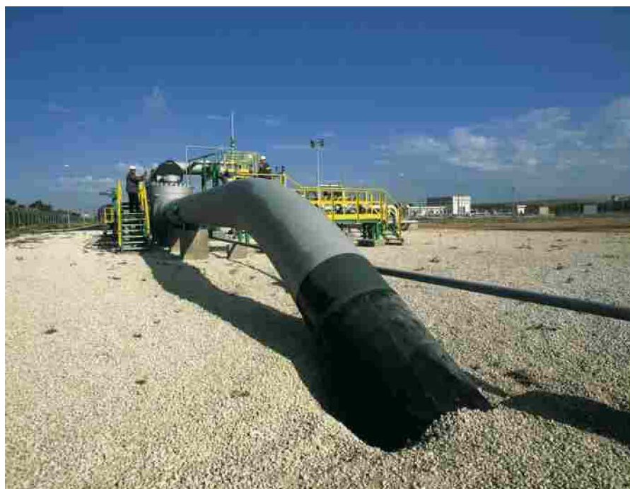
IMPIANTO DI DISTRIBUZIONE ENI GELA
