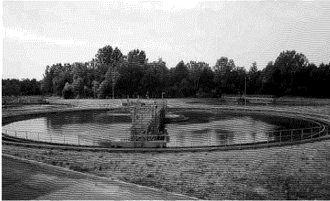
IL DEPURATORE La tesi sostenuta dal cittadino «scagionerebbe» l'impianto
