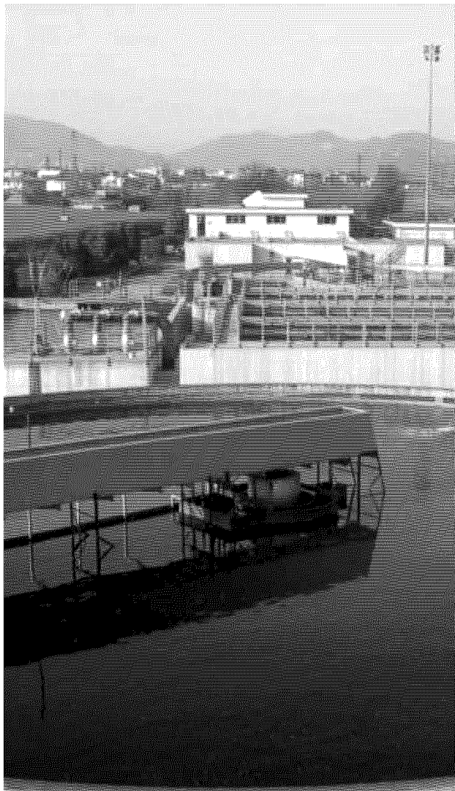
Il depuratore delle acque di Trissino
