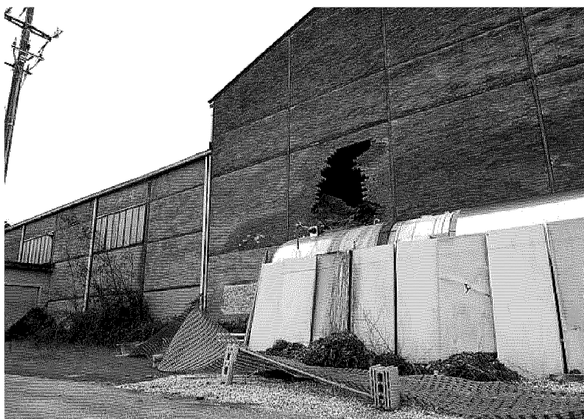
Il crollo che si è verificato nel muro di recinzione dell'impianto di Casatisma
